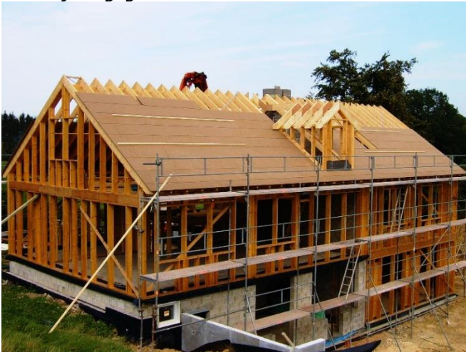
Placement des panneaux en fibre de bois de la sous-toiture Celit 4D
